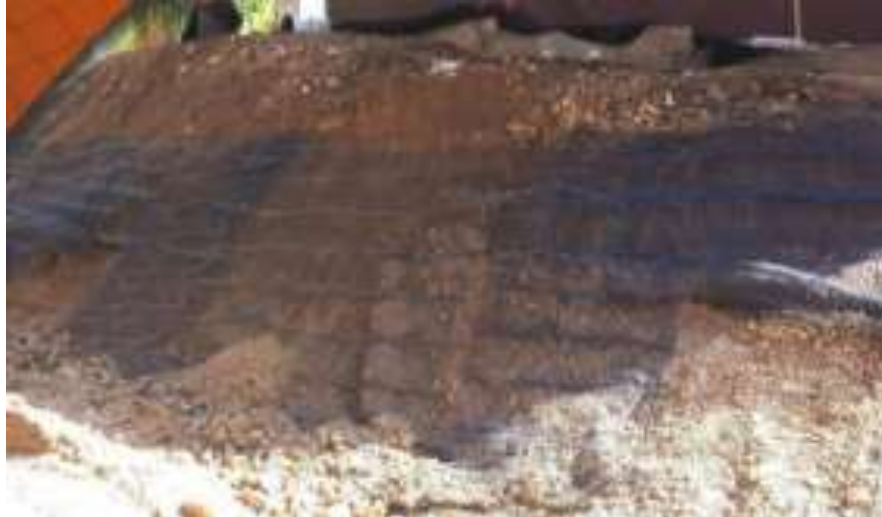
Figura 12: Deslizamiento de defensa ribereña
