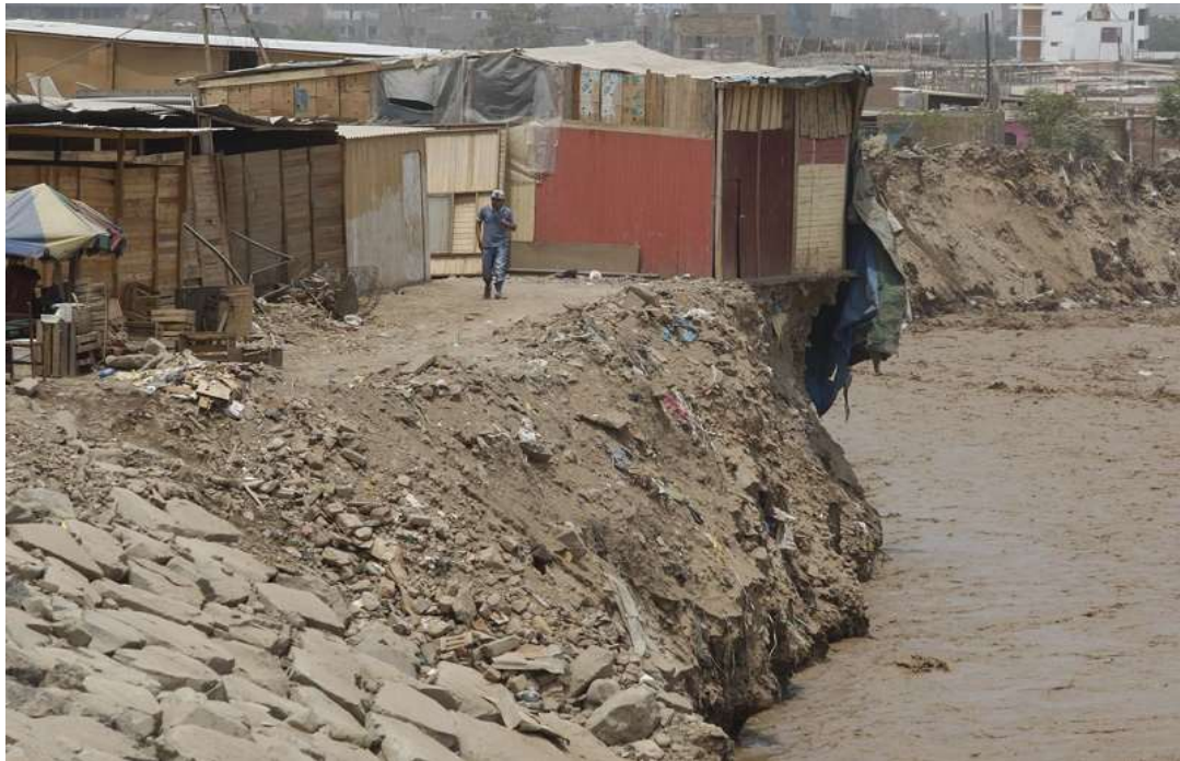
Figura 11: Inexistencia de un sistema de protección en el Río chillón
