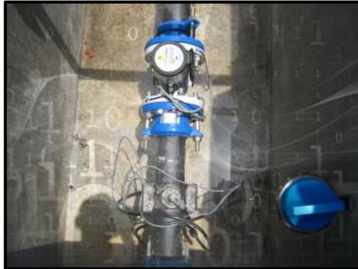
Figura N° 10: Datalogger tipo LS instalado.
