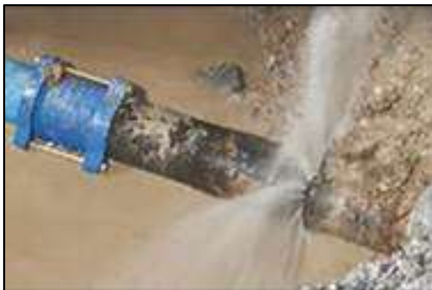
Figura N° 28: Rotura de tubería ocasionada por sobrepresión (Fuente Sedapal)
