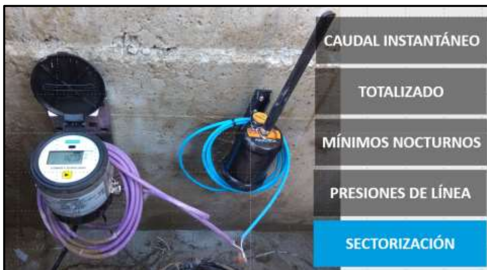
Figura Nº 12: Datalogger que permite optimizar la distribución de agua potable.
