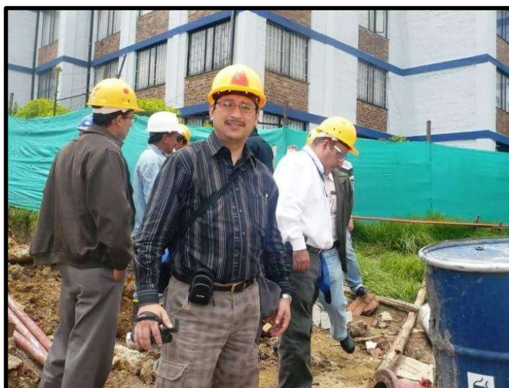
Figura Nº 09: instalación de redes de agua potable HDPE en la Urb. Micaela Bastidas en el Distrito de Los Olivos
