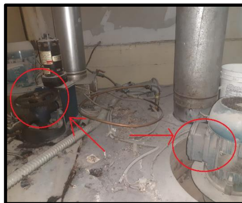
Motores eléctricos de horno
