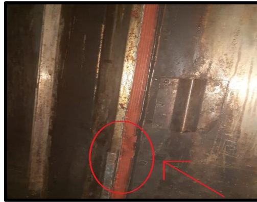
Empaquetadura en mal estado
