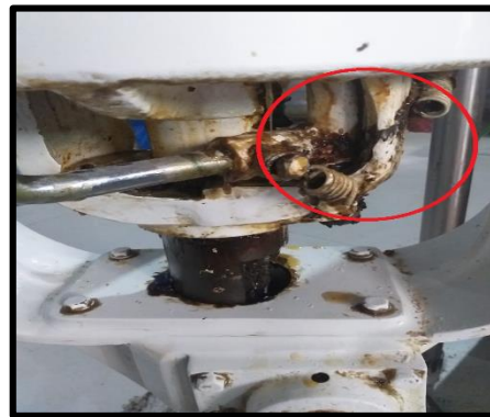
Resorte en mal estado
