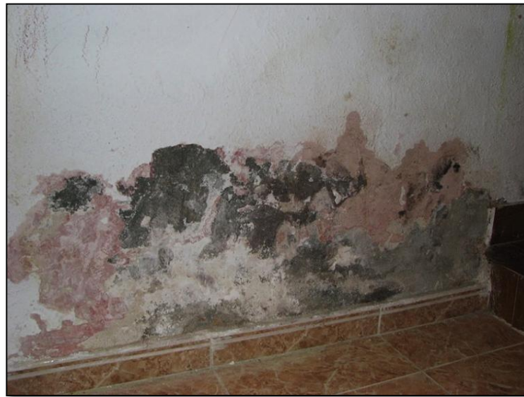
Figura 5. Humedad por capilaridad en albañilería.
