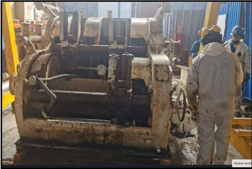
Figura 6: WINCHE DE PESCA MODELO ITALMECAN IT-25 (antes de su mantenimiento).
