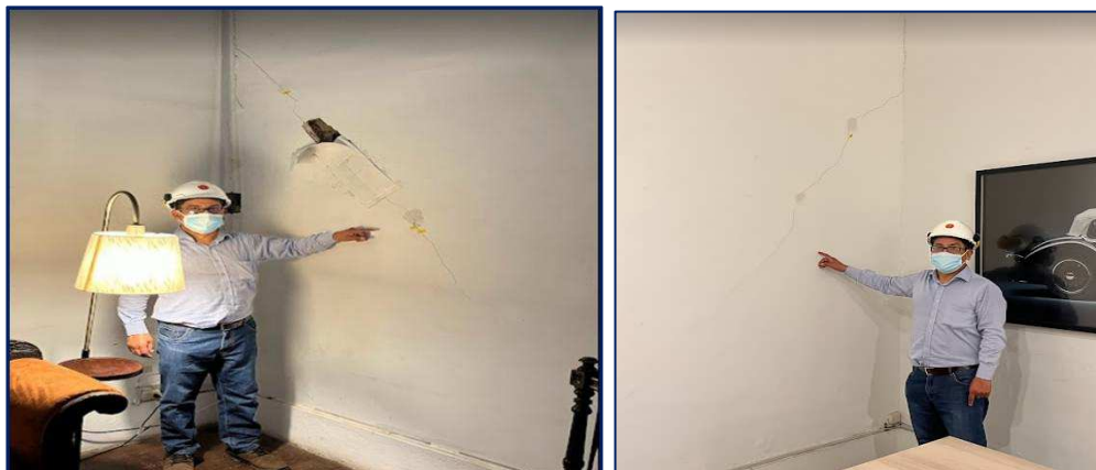
Figura 36: Daño del muro real.
