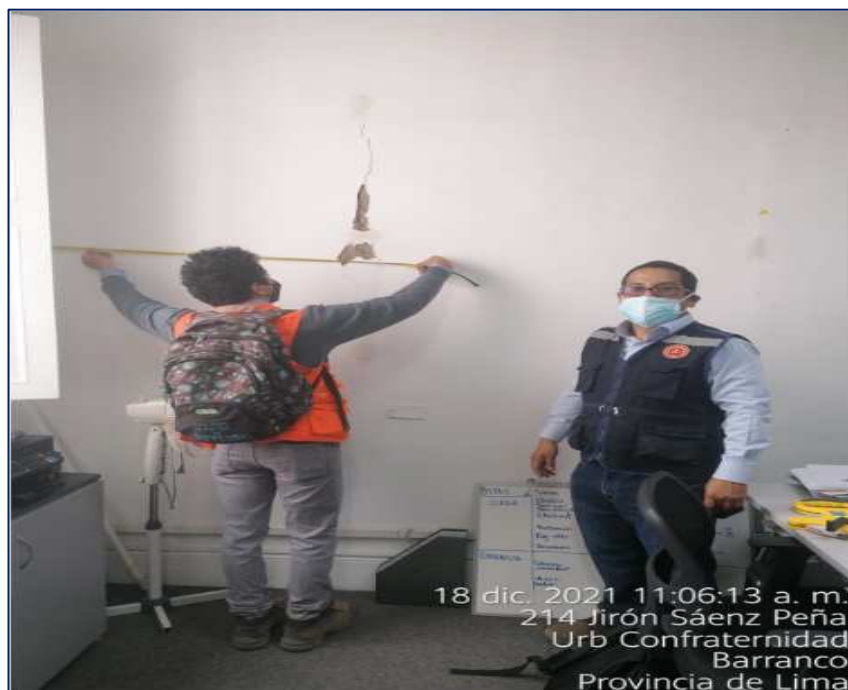
Figura 23: Levantamiento de las fisuras.
