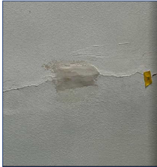
Figura 37: Control de fisuras del muro.
