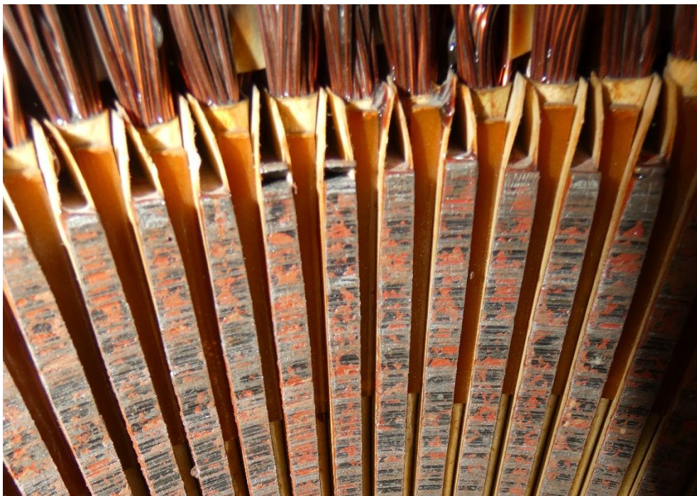
Figura D – 2: Ranuras del núcleo del estator parcialmente vacías
