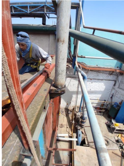
Personal se coloca el arnés para trabajo en altura pero sin la línea de vida
