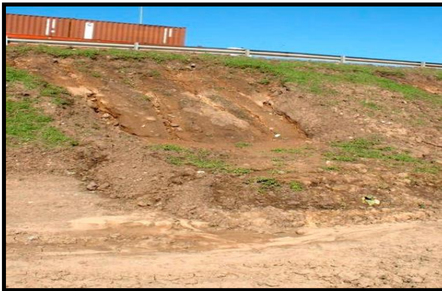
Figura 1: Deslizamiento de talud
