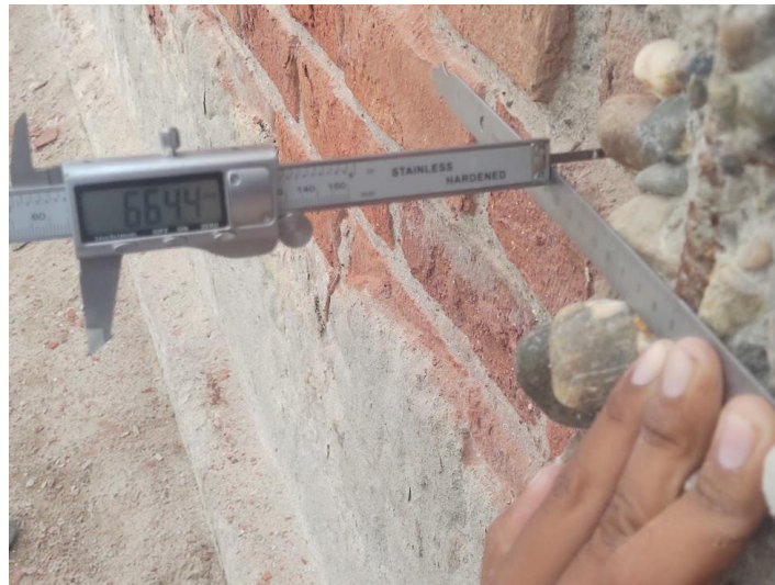
Figura 1. Nivel de erosión y corrosión en cerco perimétrico (Elaboración Propia, 2023)
