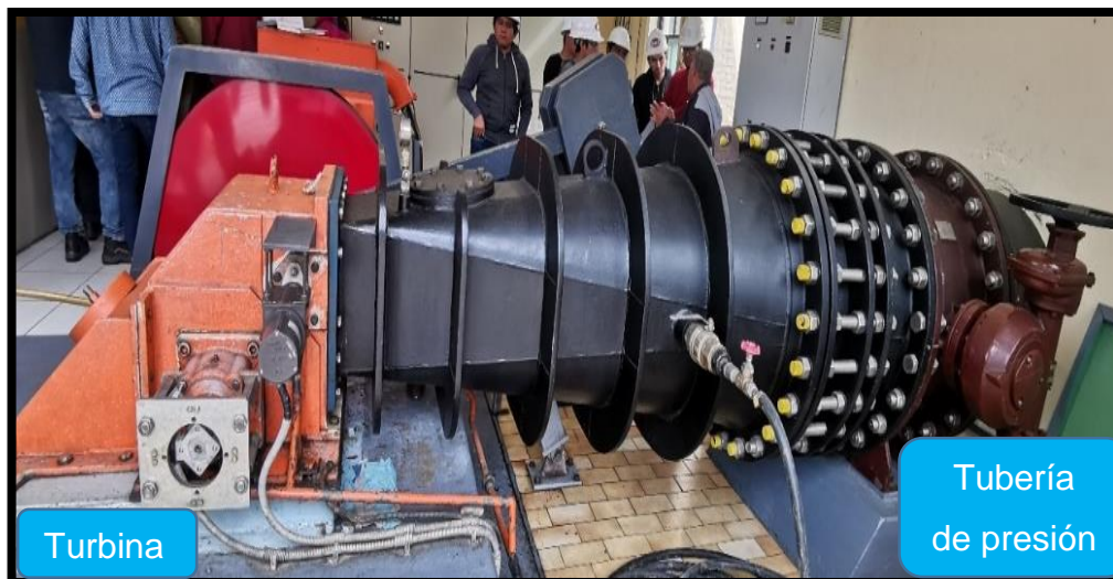
Figura 8. Minicentral hidroeléctrica gallito ciego de 270 kW
