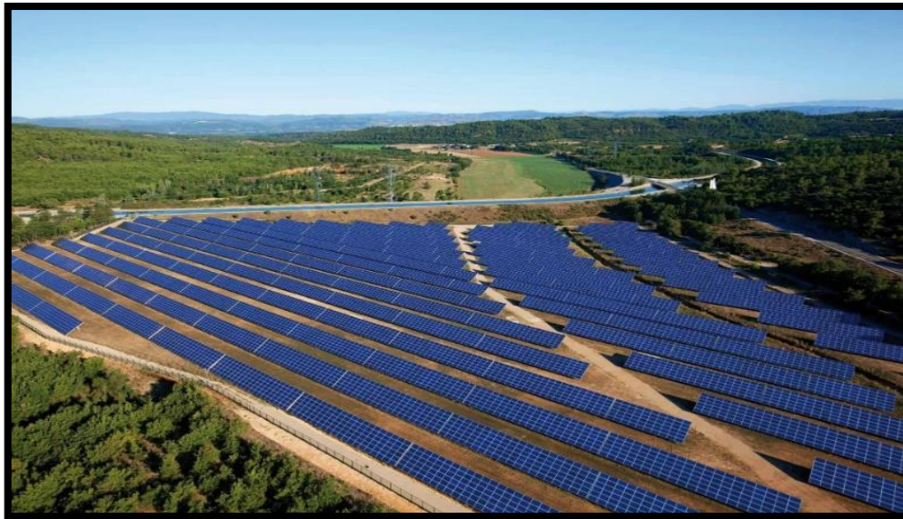
Figura 4. Paneles solares fotovoltaicos
