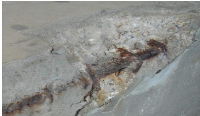
Figura 1. Carbonación del concreto
