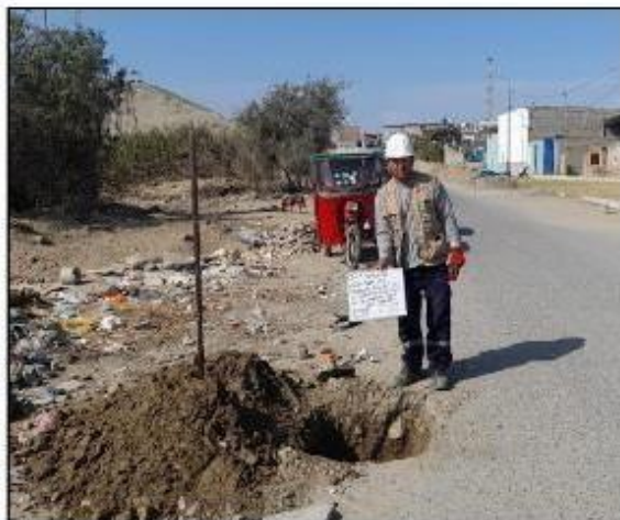
FOTOS 04: SE OBSERVA UNA VISTA PANORÁMICA DE LA EXCAVACION DE LA CALICATA C-02.
