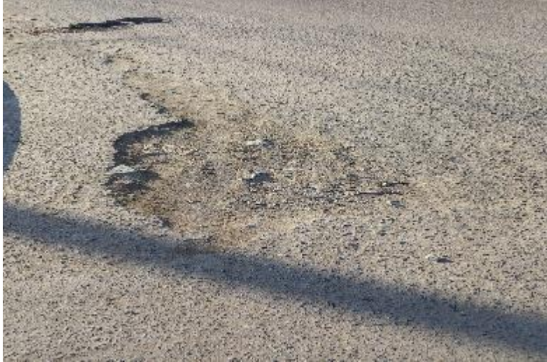
Figura N° 05: Fallas de pavimento
