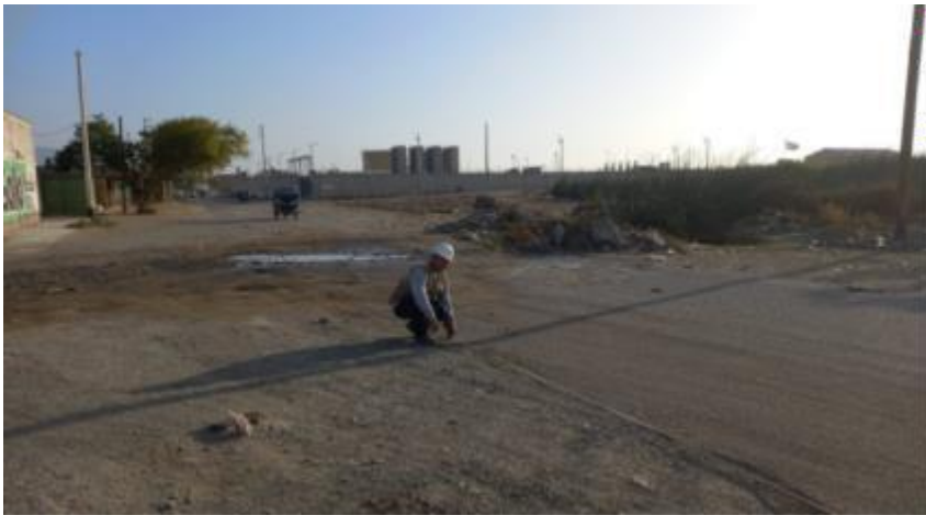
Figura N° 06: Medicion de fallas del pavimento.
