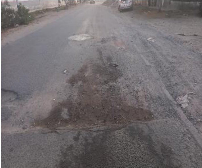
Figura N° 03: Fallas del pavimento.
