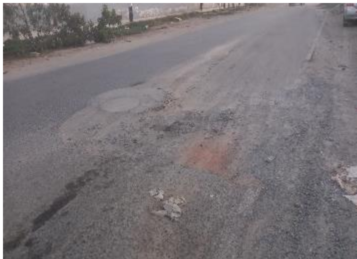
Figura N° 04: Fallas del pavimento.
