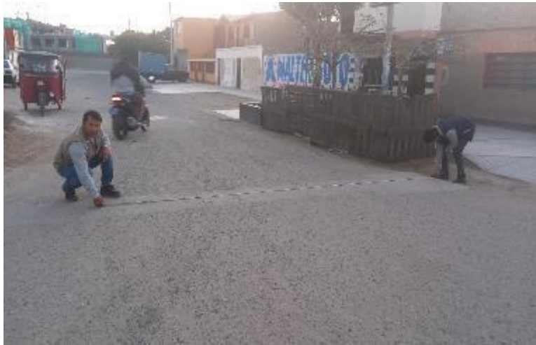
Figura N° 01: Medición de las fallas del pavimento
