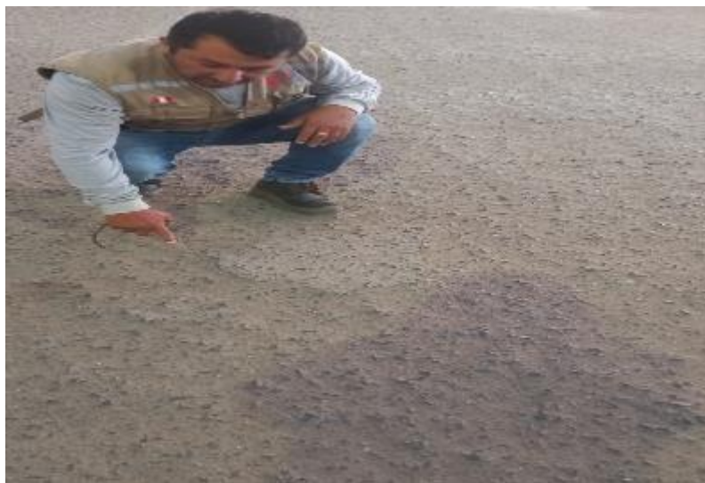
Figura N° 02: Medición de las fallas del pavimento
