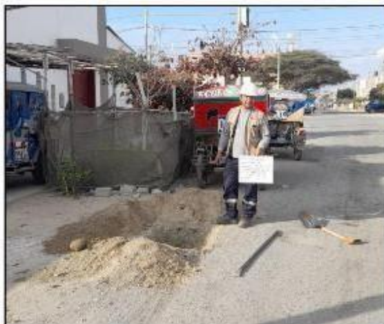
FOTOS 06: SE OBSERVA UNA VISTA PANORÁMICA DE LA EXCAVACION DE LA CALICATA C-03.
