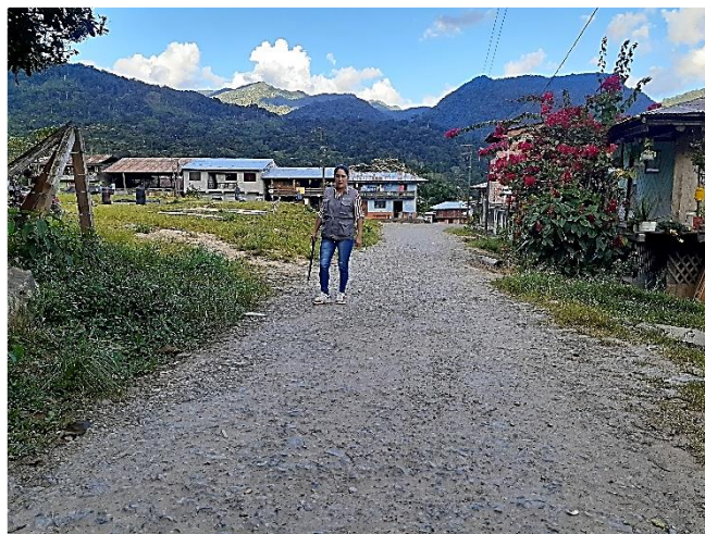
Foto 39: Infraestructura vial en riesgo de inundación localidad el Líbano
