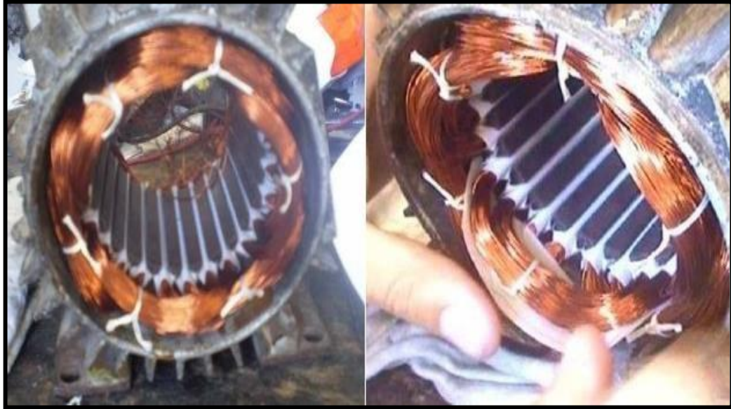
Figura 17 Aislamiento de las bobinas
