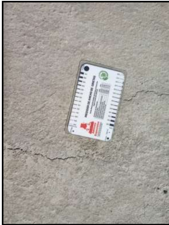
Fotografía 13. Medición de fisuras en los paños de concreto
