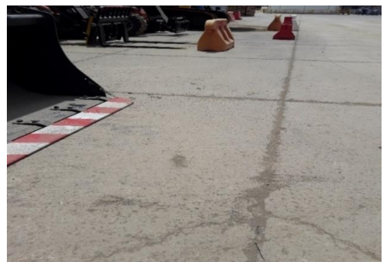
Fig. 02: Juntas dañadas y fisuradas por tránsito de maquinarias
