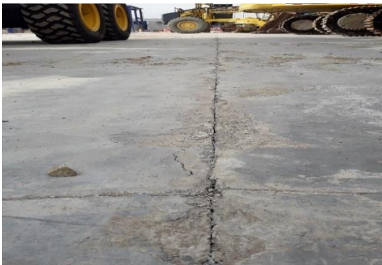
Fig.01: Labios de juntas de contracción despostilladas
