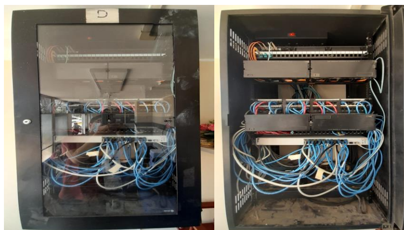
Figura 30: Instalación del Switch al Gabinete D
