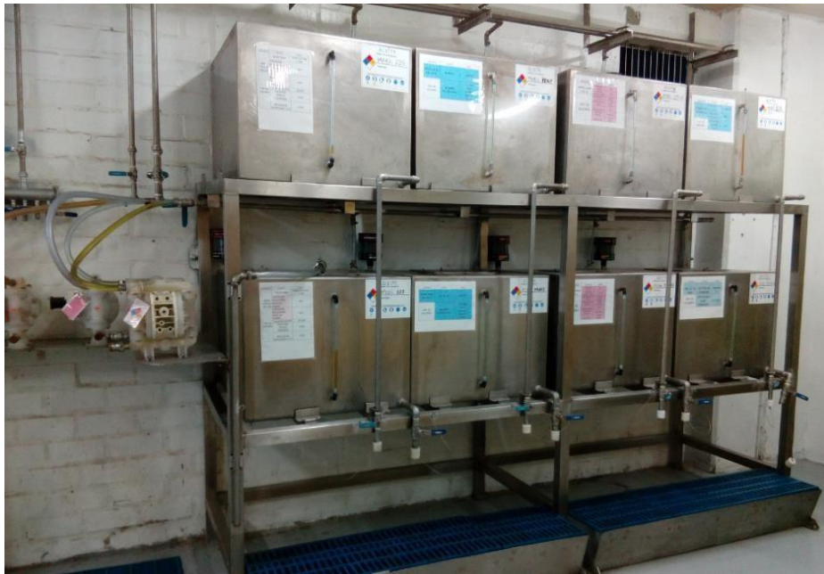
Figura 43: dispensadores de aceite para los equipos
