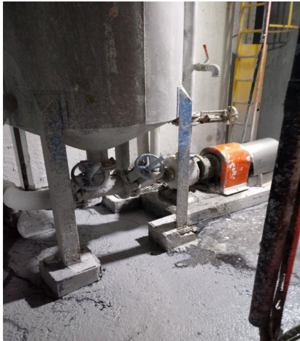
Figura 18: Equipo de bombeo de pasta 3
