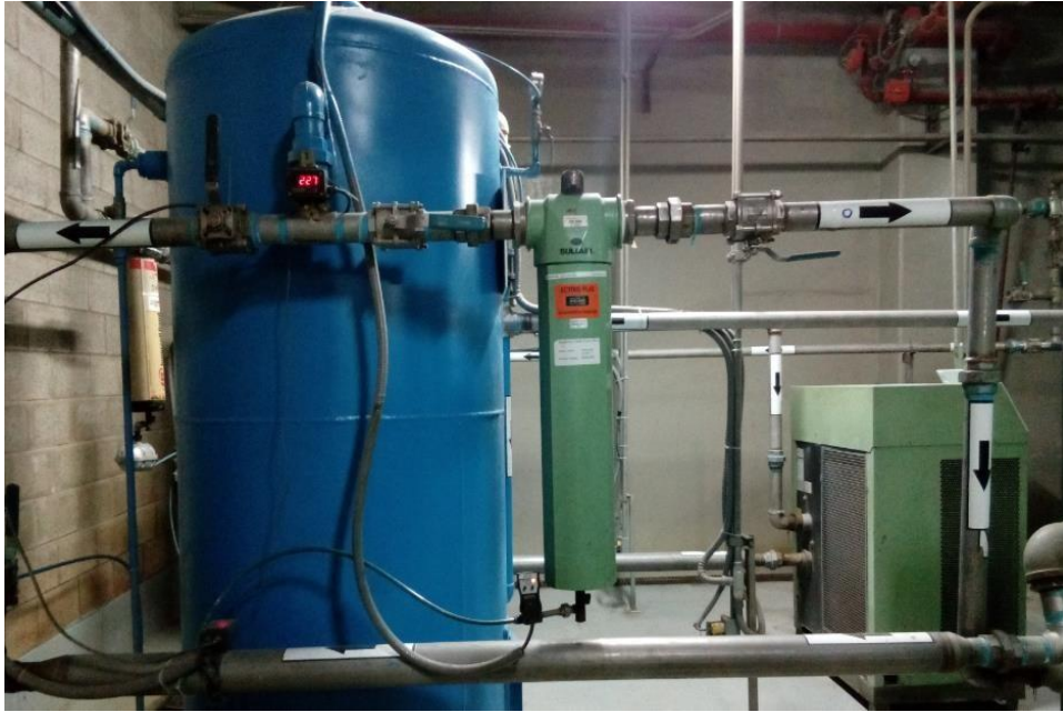
Figura 42: dispensadores de aceite para los equipos
