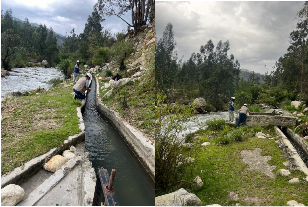
FOTOGRAFÍA N° 23: Parte del canal de captación, aguas turbias.
