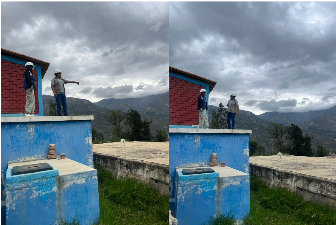
FOTOGRAFÍA N° 22: Detalles del estado actual del reservorio, donde se encuentra en pésimas condiciones.
