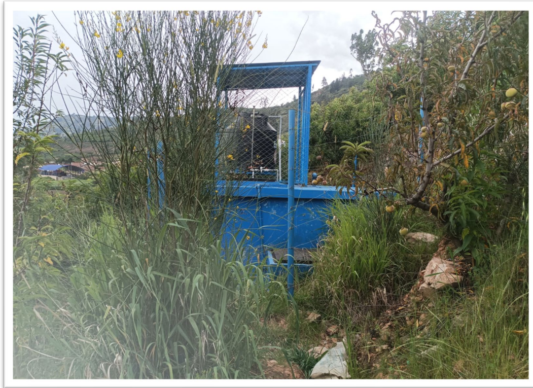
FOTOGRAFIA 09: SE OBSERVA UN RESERVORIO CON TANQUE PARA CLORACION
