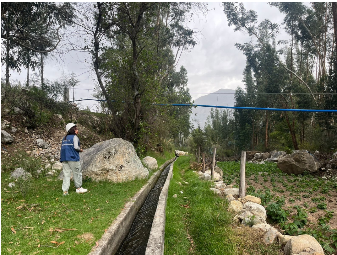
FOTOGRAFÍA N° 25: Pase aéreo existente, la cual ya cumplió su periodo de construcción.
