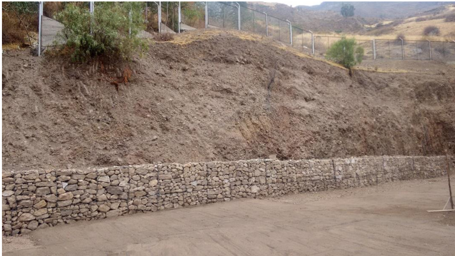
Figura 17. Muro de gaviones.
