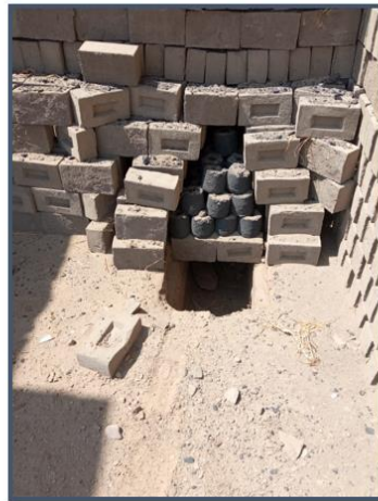
CÁMARA DE COMBUSTIÓN
