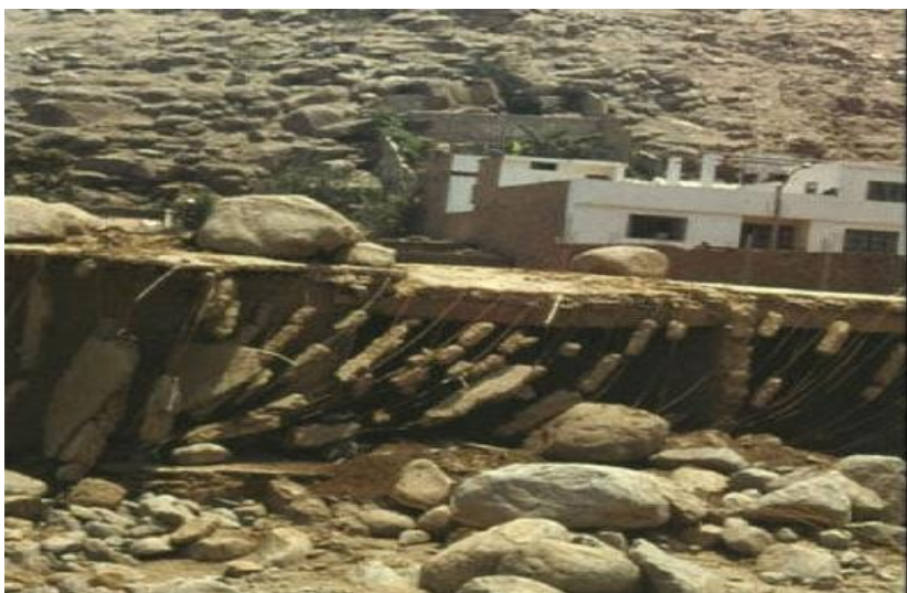
Figura N° 37 Viviendas destruidas por la venida del Huayco
