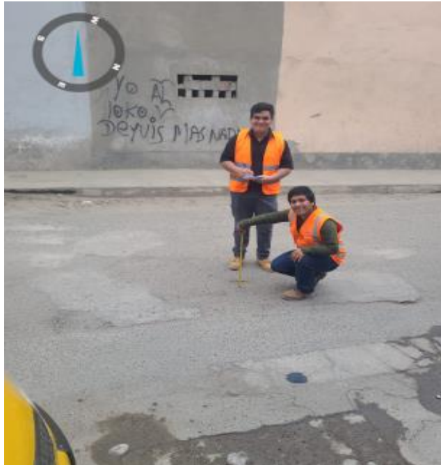
Figura 7: Falla por hundimiento de 5cm
