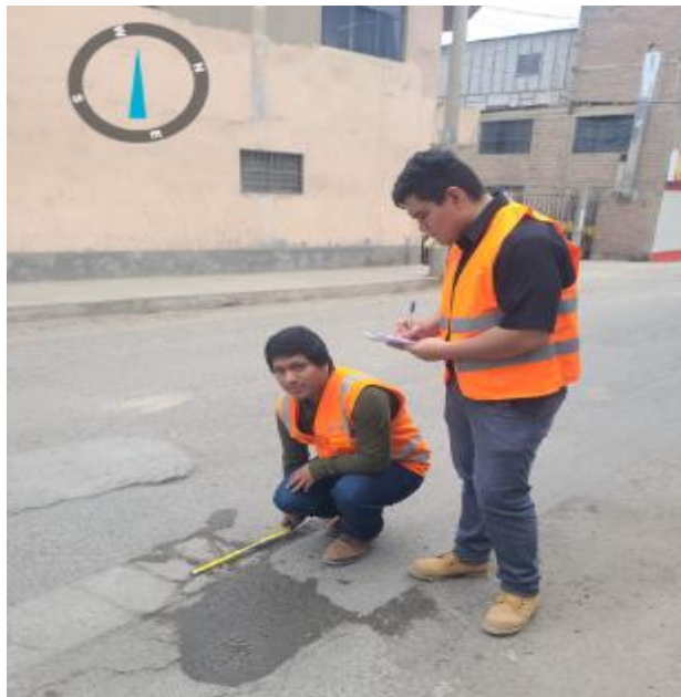
Figura 8: Falla de agrietamiento en bloque
