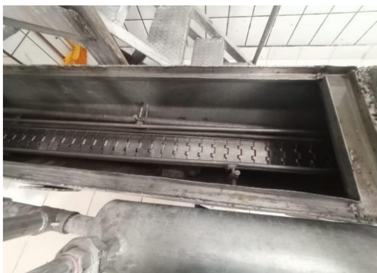
Figura 5. Mantenimiento de Exhausting
