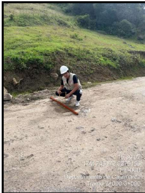
Figura 6. Presencia de baches y huecos.
