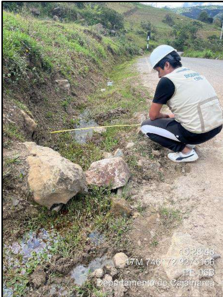
Figura 2. Presencia de vegetación y material en las cunetas sin revestir.
