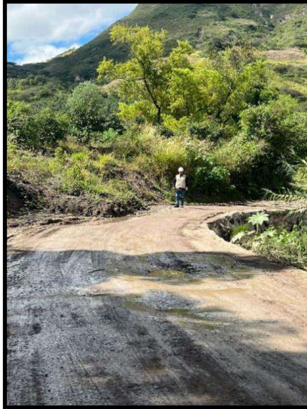
Figura 5. Consecuencia de las fuertes lluvias de la zona.
