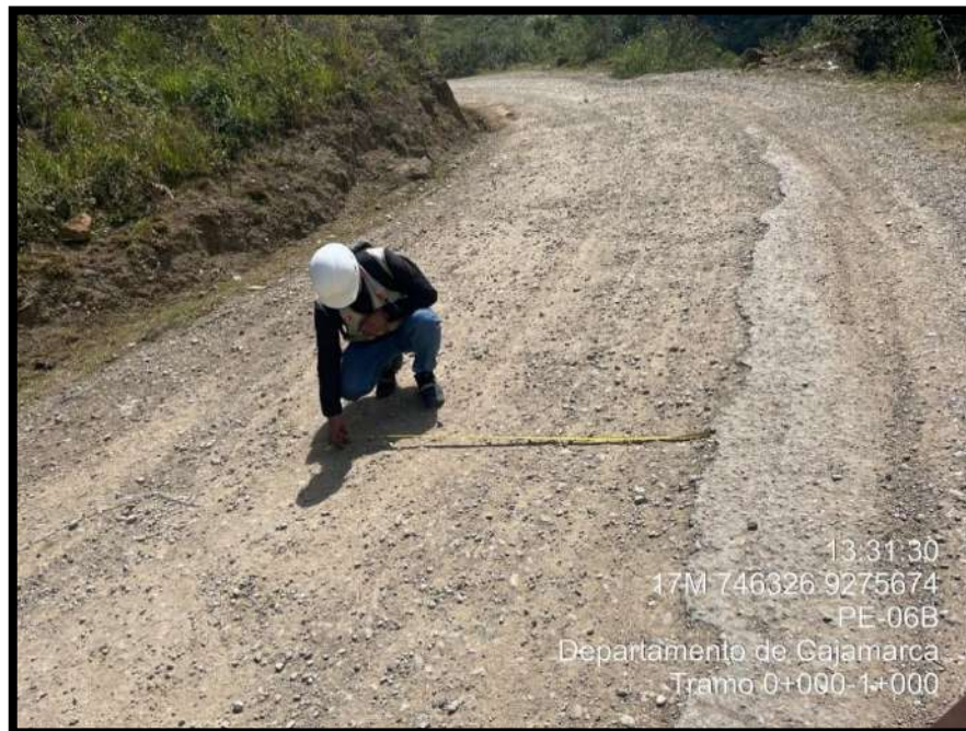
Figura 8. Presencia de baches y huecos.
