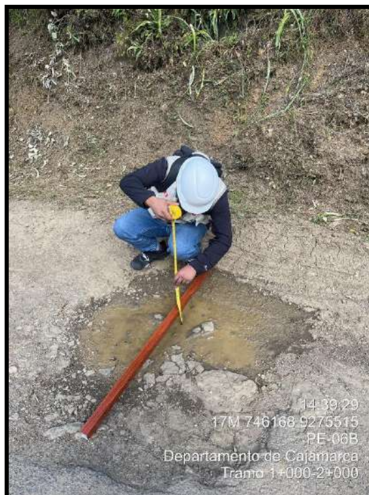
Figura 6. Baches ocasionados por las lluvias.
