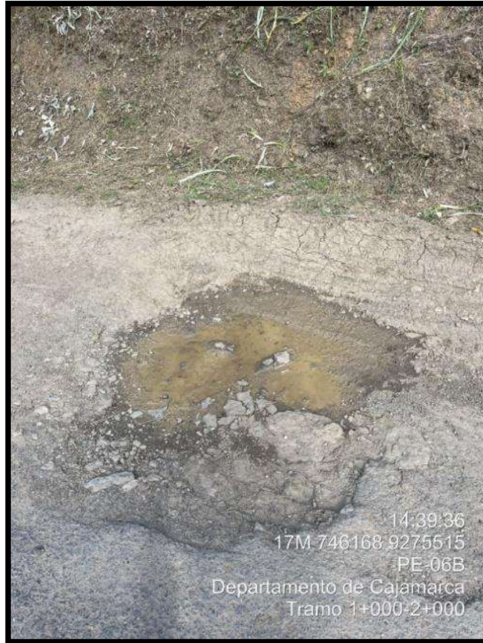
Figura 7. Presencia de baches y huecos.
