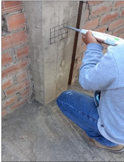
Figura 8 Ensayo de esclerometría
