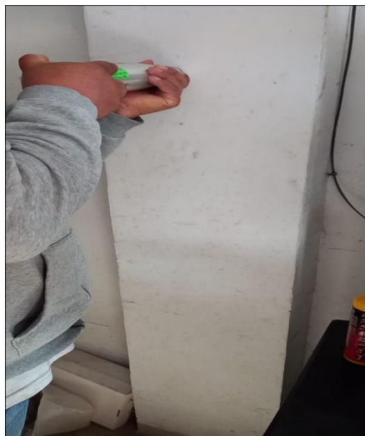
Figura 9 Ensayo de esclerometría
