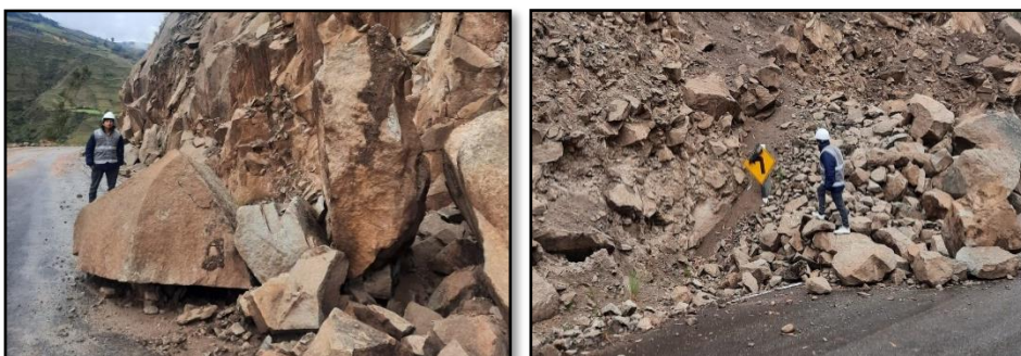
Figura 1. Taludes rocosos inestables a lo largo de la carretera
