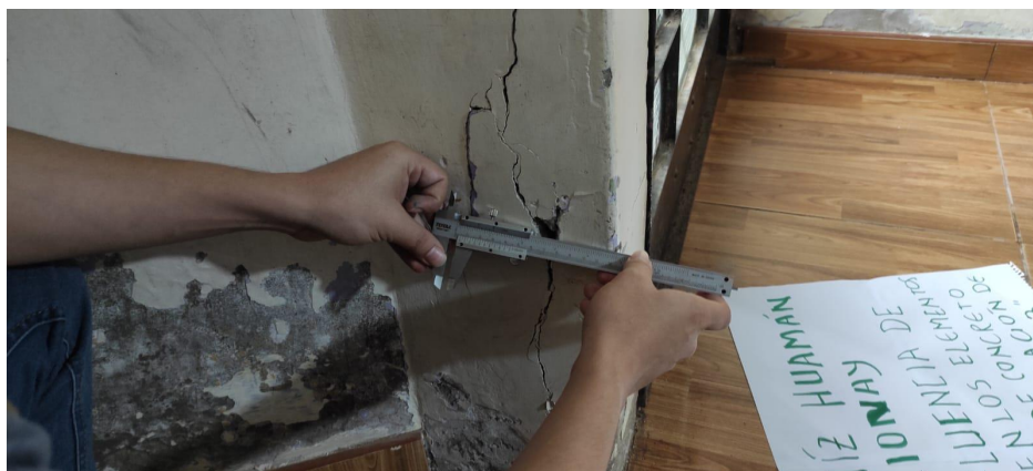
Figura 40. Medición con vernier el tamaño de abertura de grieta
