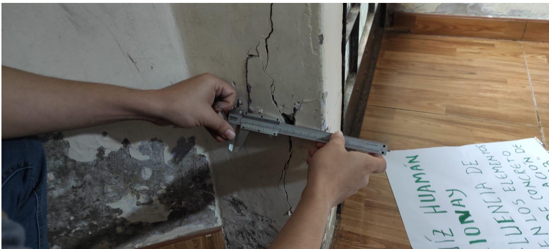
Figura 11. Medición de ancho y profundidad de las grietas utilizando el vernier
