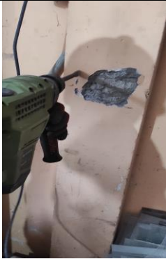
Figura 21. Retiro del tarrajeo, para que se vea el concreto de la columna
