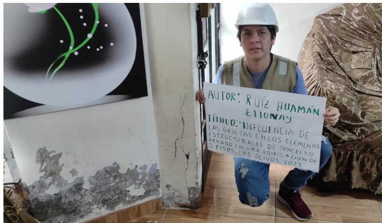
Figura 42. Tamaño de abertura de grieta en elemento estructural-columna
