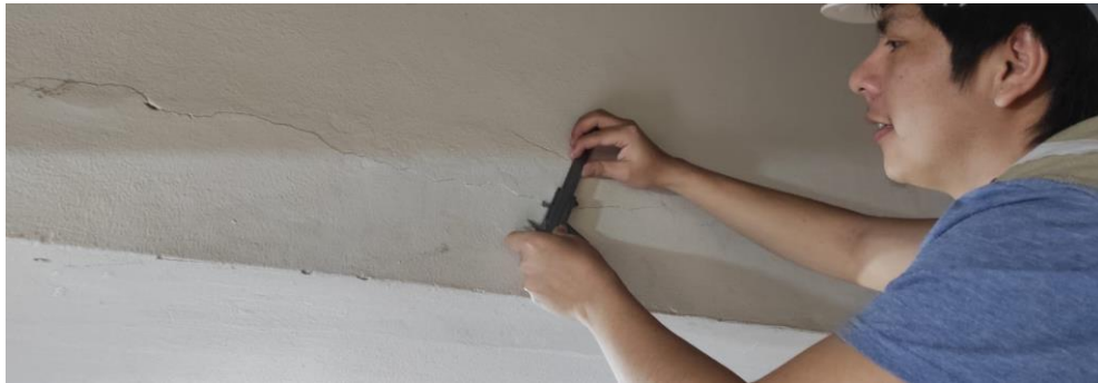
Figura 41. Tamaño de abertura de grieta en viga
