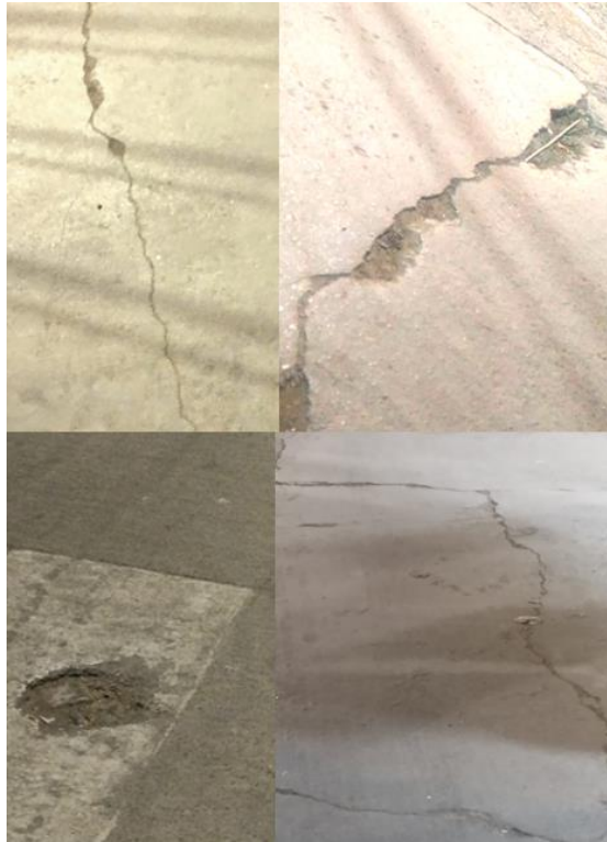
Figura 1. Problemas en los pavimentos rígidos en llave.
