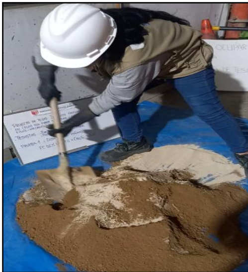
Figura 32. Combinación de los materiales
