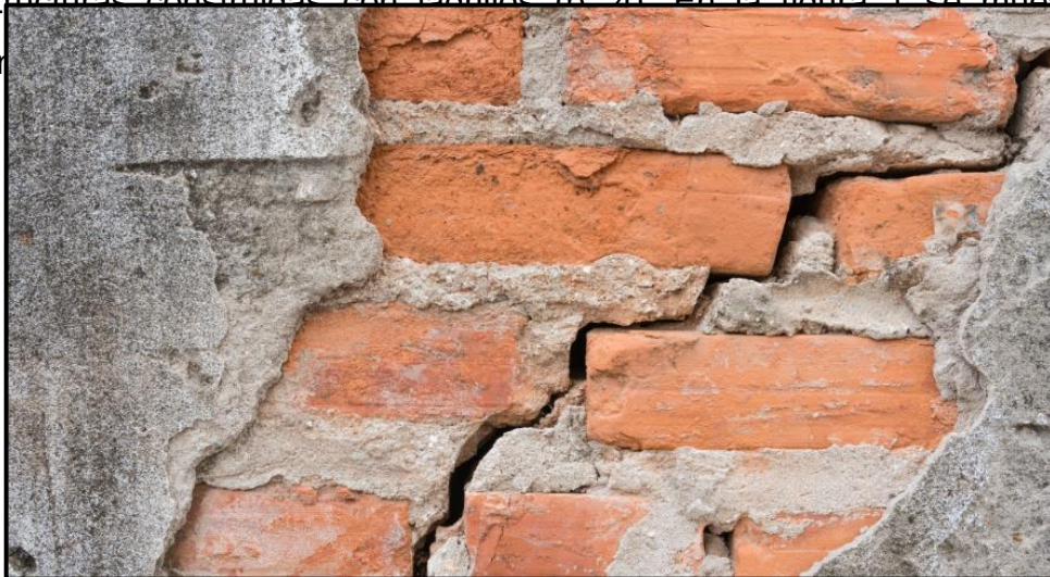
Figura 1. Agrietamientos en ladrillos Fuente: https://bit.ly/2OPPIX0
