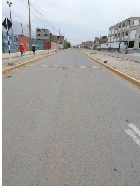
Figura 26: Situación actual referente al estado de conservación de pista en la Av. Industrial
