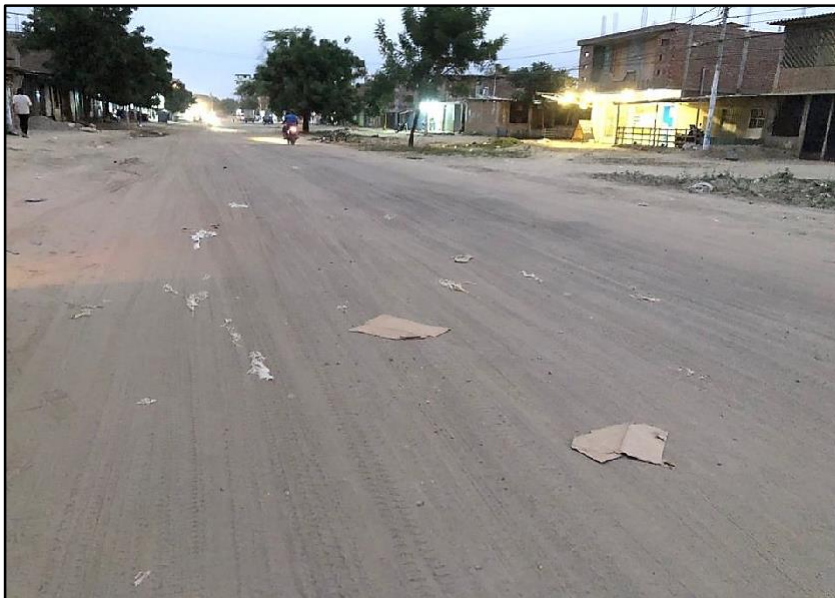
Figura N° 32. Mal estado de la avenida los Algarrobos
