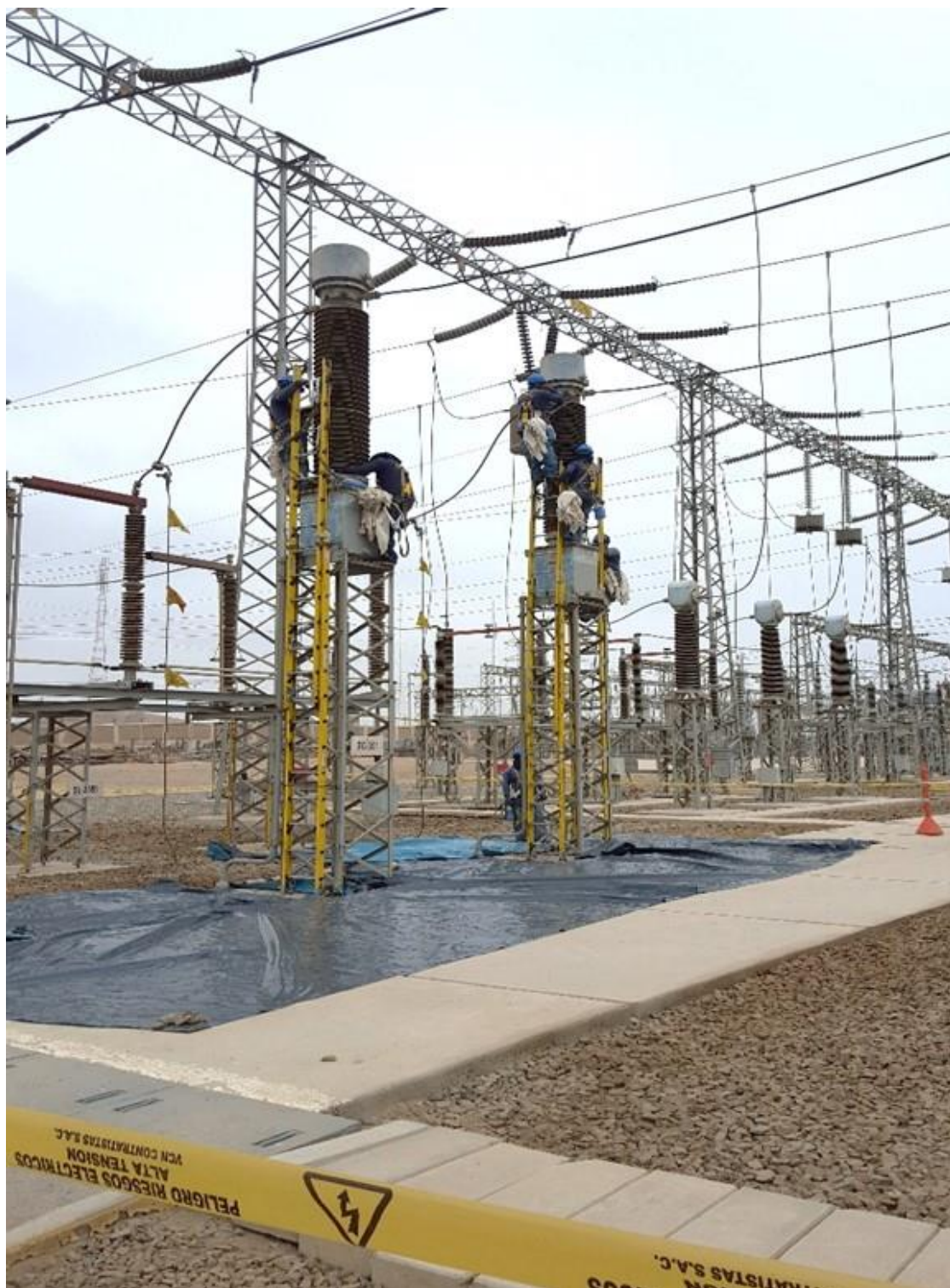
Figura 36 Personal de VCN retirando la grasa silicona saturada del TC-351 L-2240
