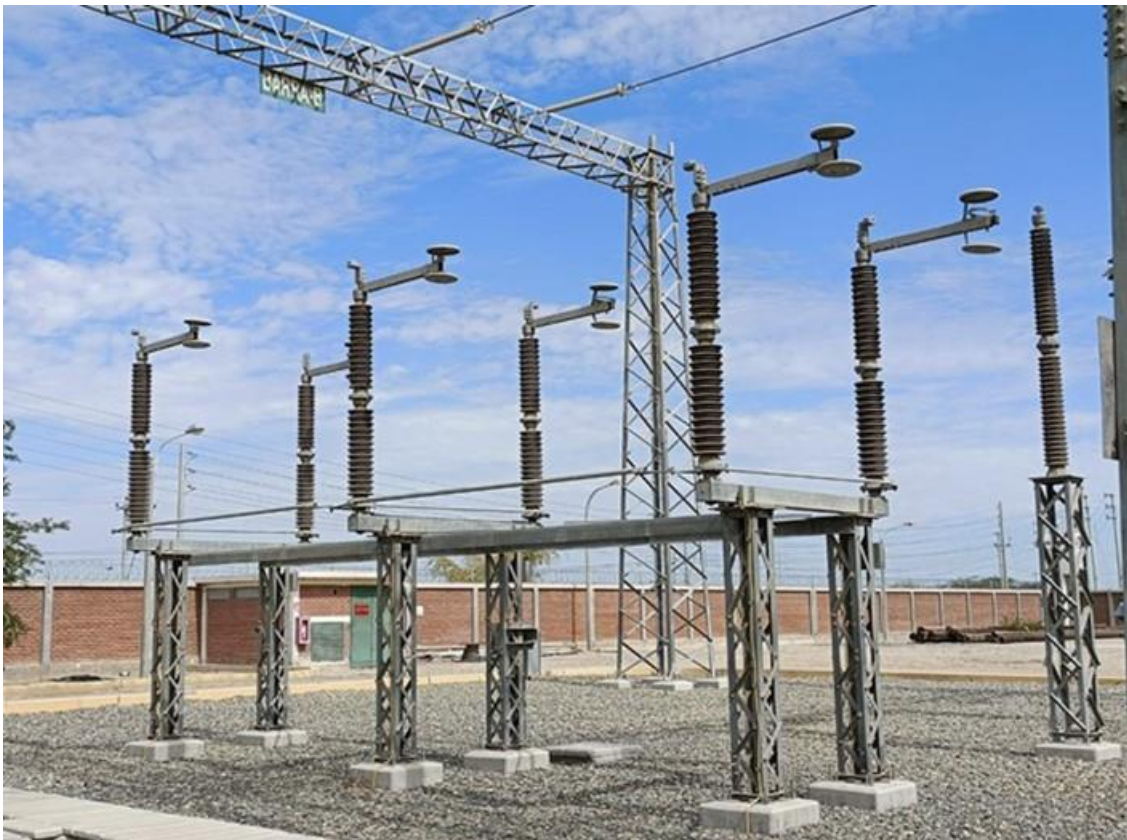
Figura 6 Seccionador de corte central 220 kV Marca AEG Modelo FMS-414
