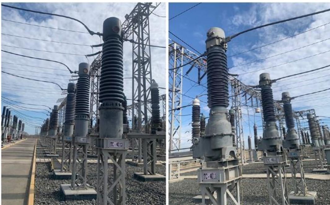
Figura 39 Transformador de corriente 4011 y 4012 con goma RTV Fuente: Imagen capta en la subestación Chimbote 138KV.
