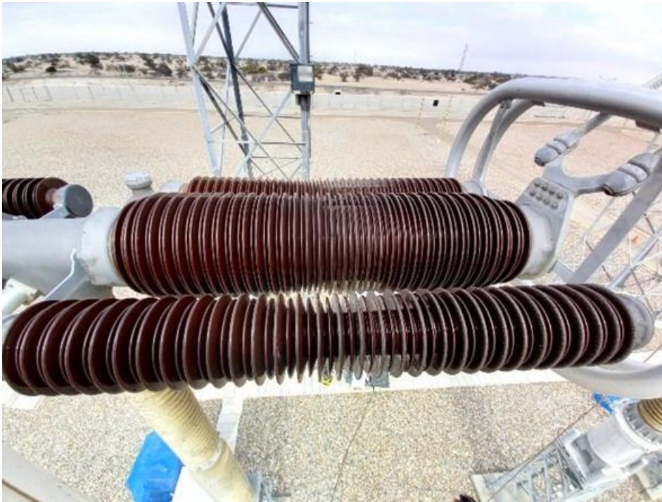
Figura 45 Vista superior de interruptor IN-5162 preparado para aplicar goma RTV. Fuente: Subestación eléctrica la Niña 500 kV interruptor IN-5162
