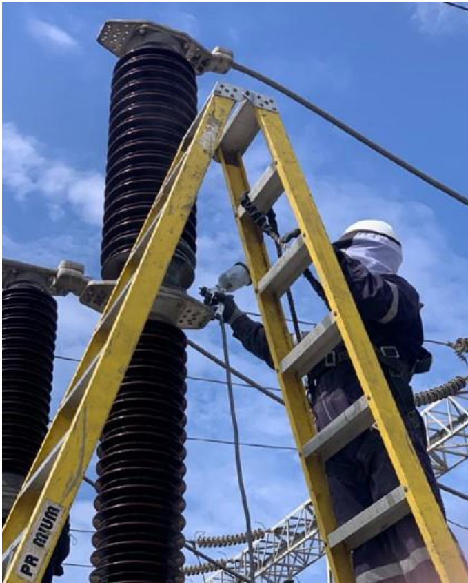
Figura 38 Aplicación de goma silicona sobre IN4006 mediante método tradicional Fuente: Imagen capta en la subestación Chimbote 138KV.
