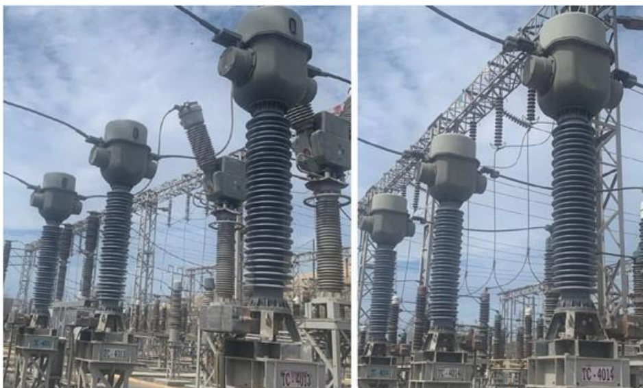
Figura 41 Transformador de corriente 4013 y 4014 con goma RTV
