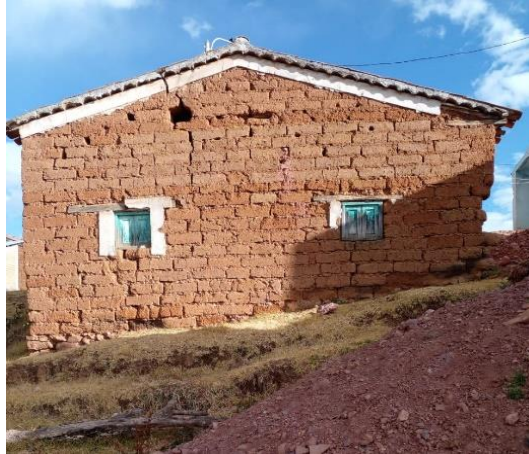
Figura 1. Vivienda de Adobe con fallas de fisura y grieta.
