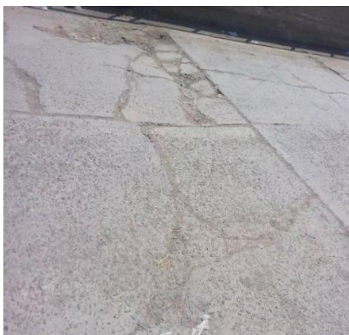
Figura N° 11: Fallas en pavimento rígido
