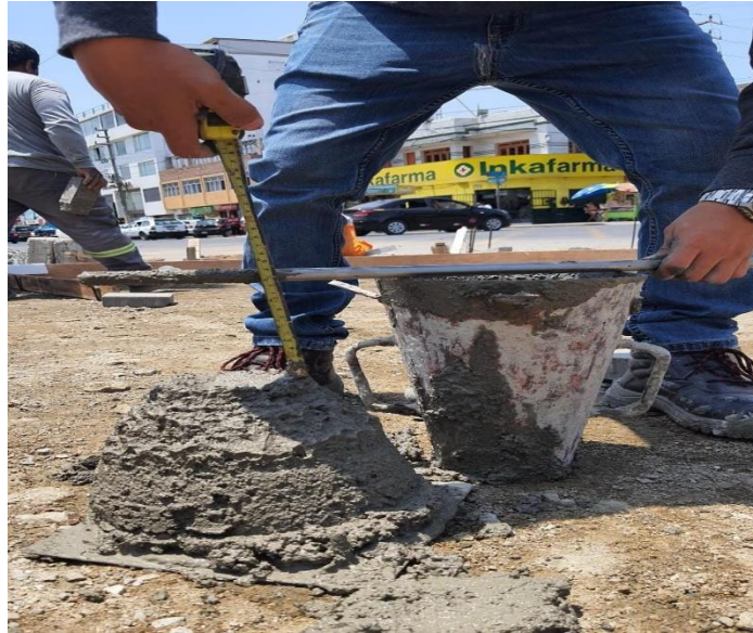
Figura N° 05: Asentamiento del concreto fresco
