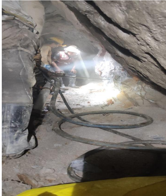
Figura 20. Verificación de rendimiento de los equipos
