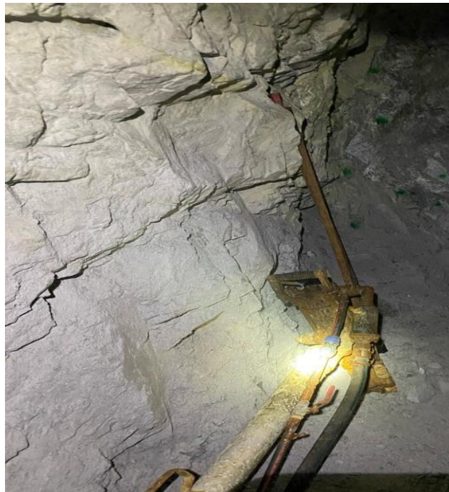
Figura 15. Verificación del estado de la perforadora YT - 29
