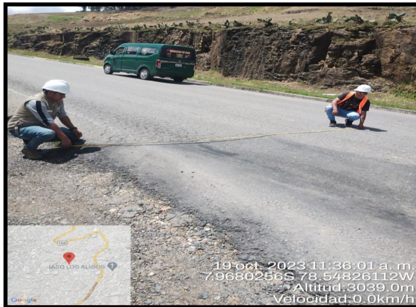
Fotografía 13: Se muestra la medición de las áreas para luego obtener las dimensiones y severidades de las fallas existentes, para obtener el índice MDR.
