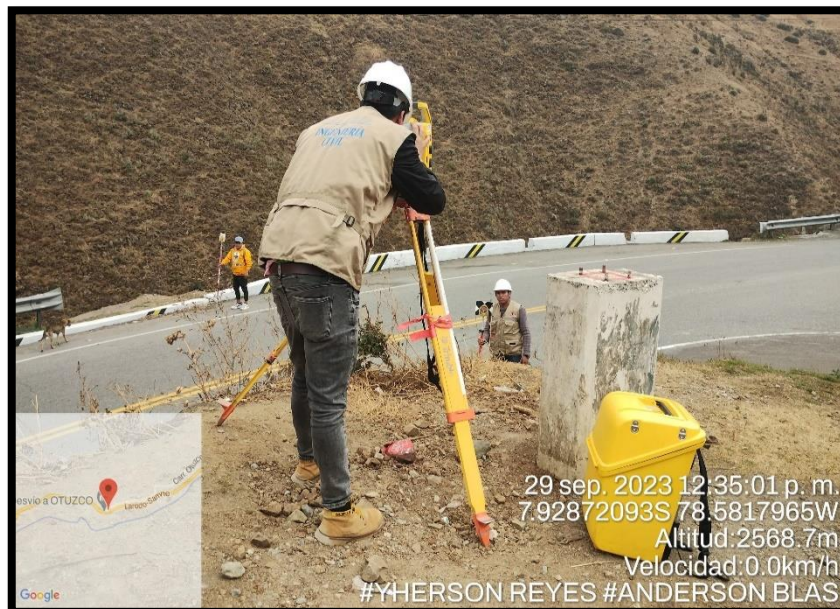
Fotografía 12: Inicio del levantamiento desde la progresiva 071+000 hasta progresiva 083+000 con el fin de reconocer el tipo de terreno, ubicar nuestras áreas afectadas y desarrollar el perfil longitudinal de la zona de estudio.
