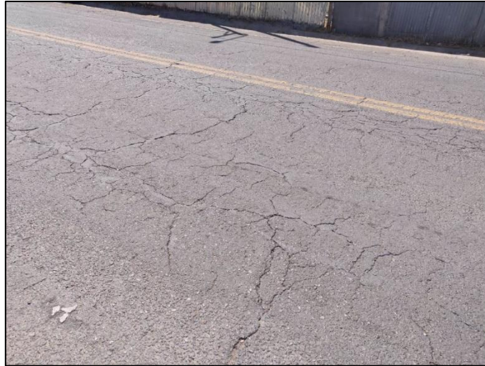
Imagen 02. Falla Agrietamiento en bloque
