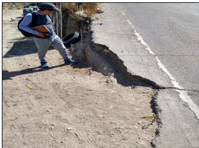
Imagen 05. Falla tipo Desnivel de Carril/berma
