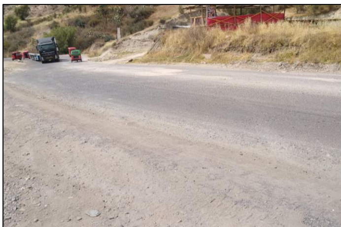
Imagen 08. Falla tipo Pulimiento de agregados
