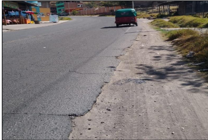
Imagen 04. Falla tipo Grietas de borde
