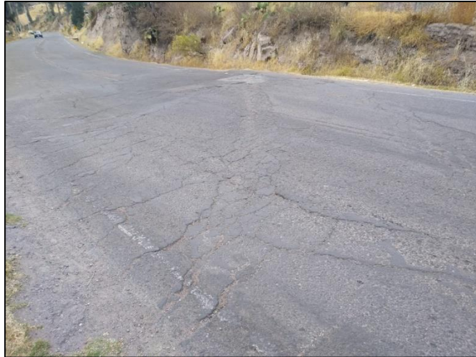
Imagen 03. Falla tipo Abultamientos y Hundimientos
