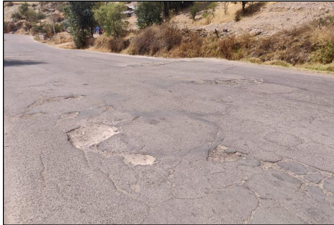
Imagen 09. Falla tipo hueco
