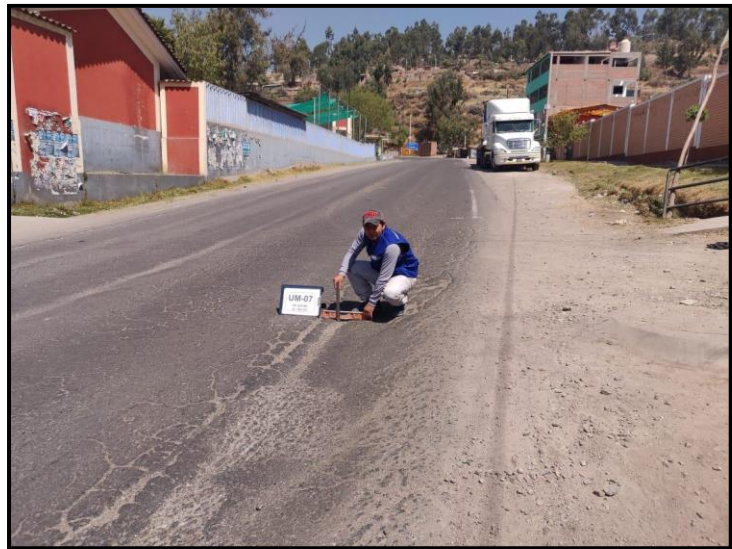
Daño en el pavimento de tipo corrugación en la unidad muestral 07
