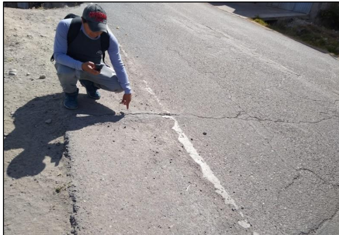
Imagen 06. Falla tipo Grietas Longitudinales y transversales
