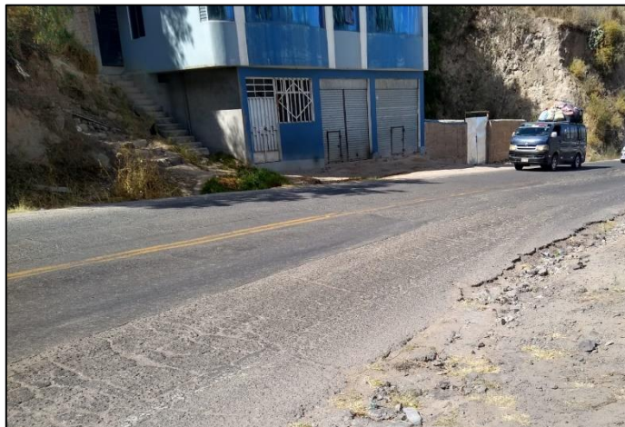
Imagen 07. Falla tipo Grietas Parcheo y Acometidas de Servicios Públicos
