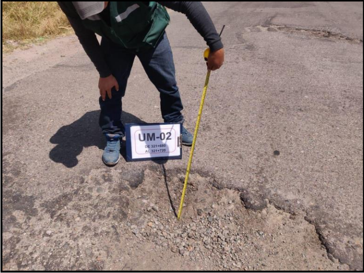
Daño en el pavimento de tipo huecos en la unidad muestral 02
