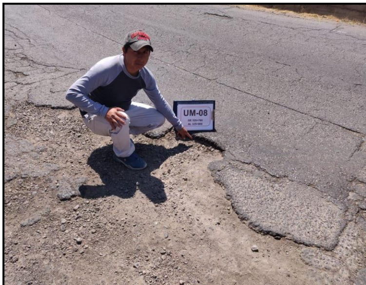
Daño en el pavimento de tipo grieta de borde y huecos en la unidad muestral 08.
