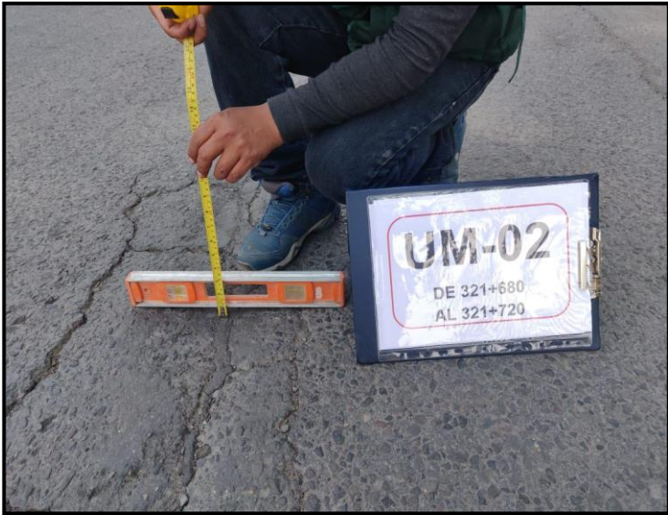
Daño en el pavimento de tipo abultamientos y hundimiento en la unidad muestral 02
