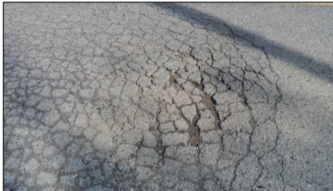
Imagen 01. Daño piel de cocodrilo
