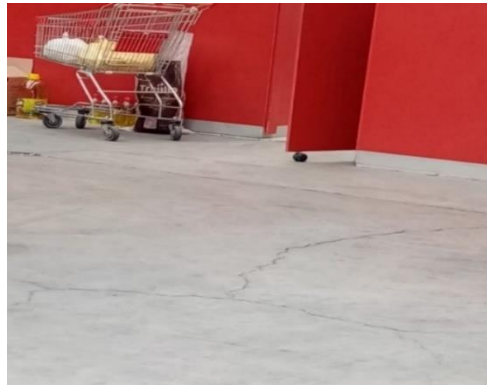
Figura N° 01. Propagación de rajadura
