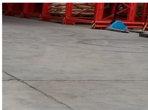
Figura N° 02. Rajadura y degradación de la losa
