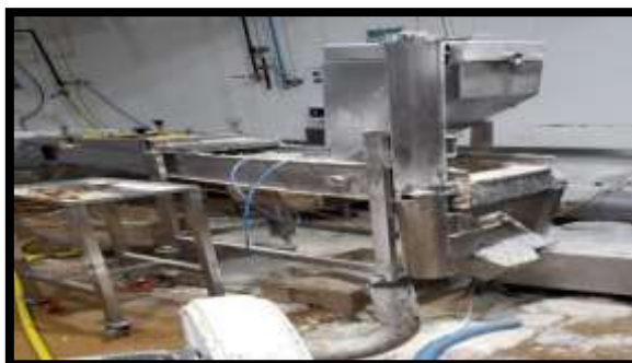
Figura 2. Maquinaria Sucia y sin mantenimiento.
