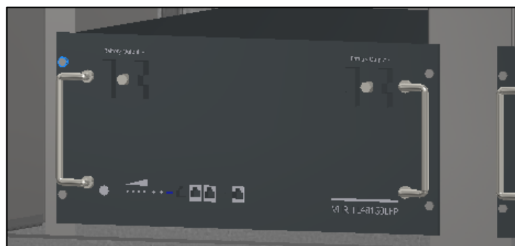
Figura 50. Fijación de batería en tablero solar. Fuente: Elaborado por los investigadores.
