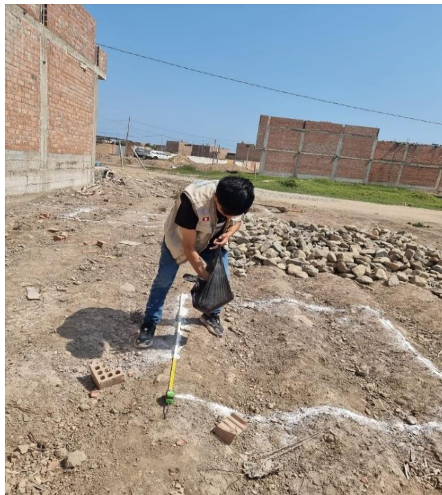
Figura 28: Trazado para realizar las tres calicatas de 1.5m x 1.5m. Fuente: Elaboración propia
