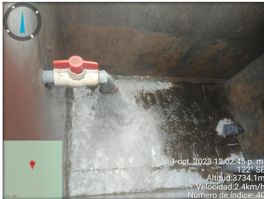
PRESENCIA DE AGUA EN LA CÁMARA ROMPE PRESIÓN TIPO VI
