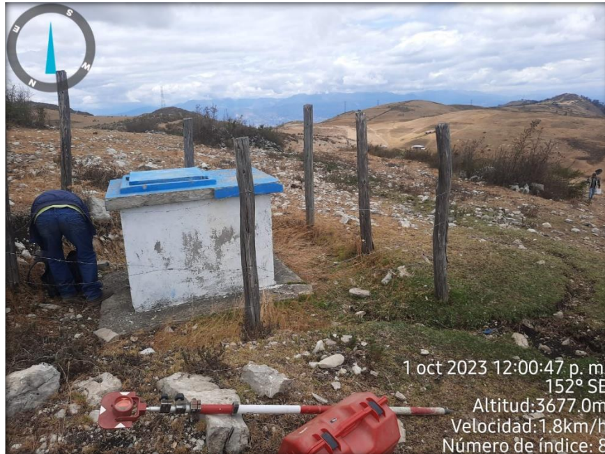
PRESENCIA DE CAJA ROMPE PRESIÓN EN DETERIORO.
