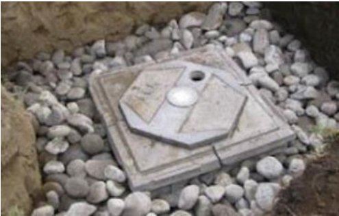
Pozo de infiltración
