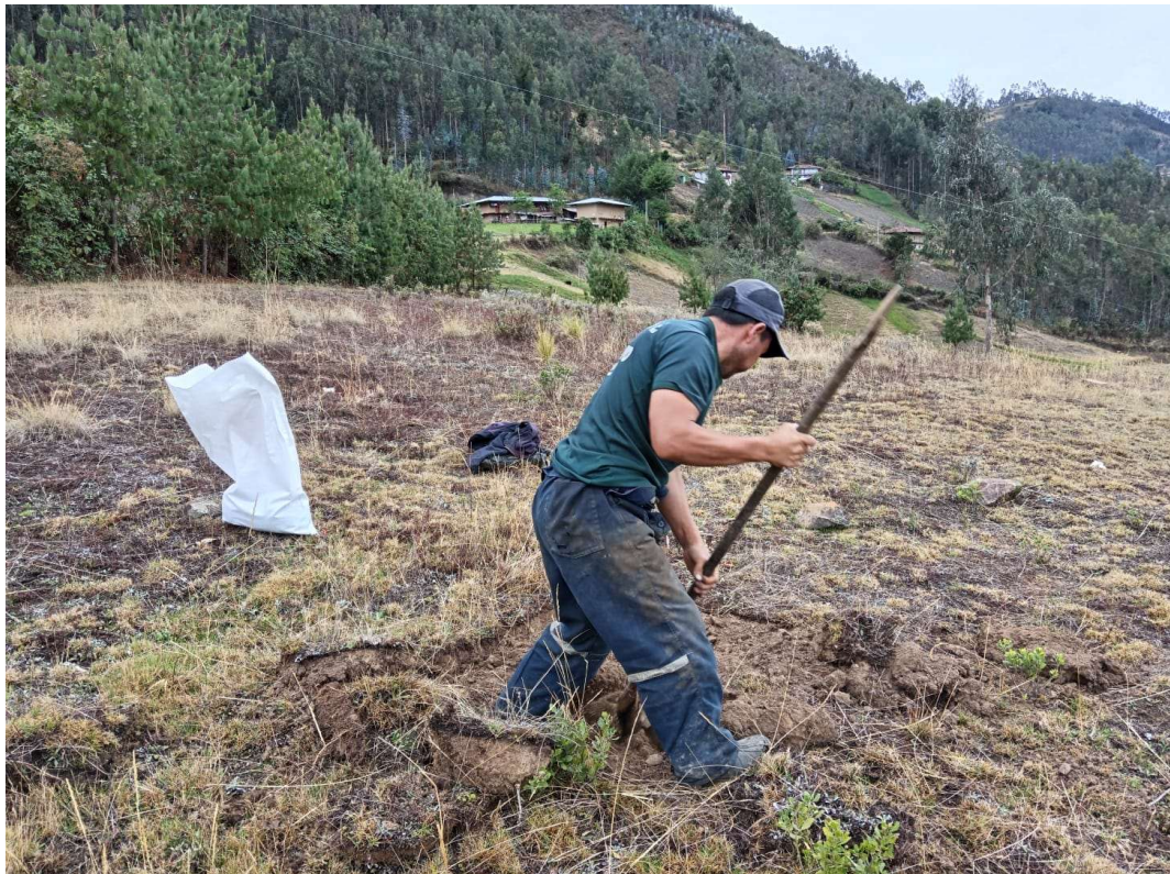
Foto N° 05: Se aprecia en la foto morador del anexo empezando excavación de calicata.
