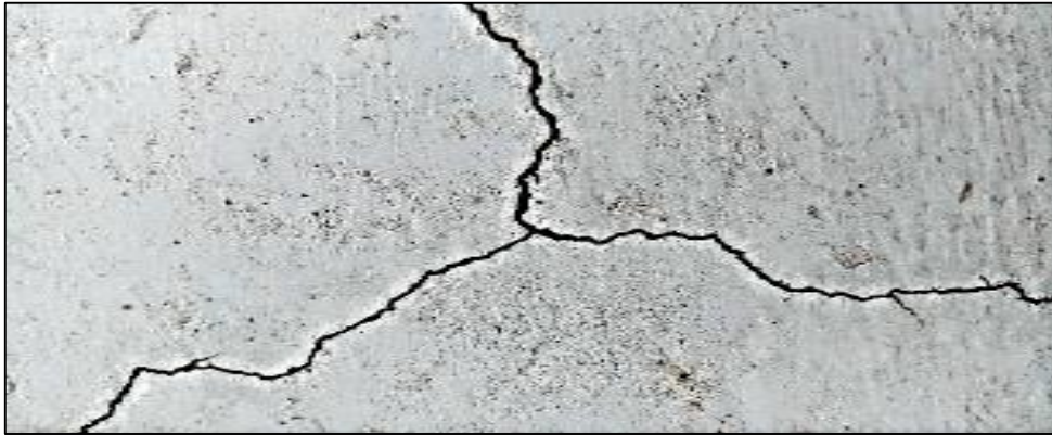
Figura 8. Fisuras en el concreto
