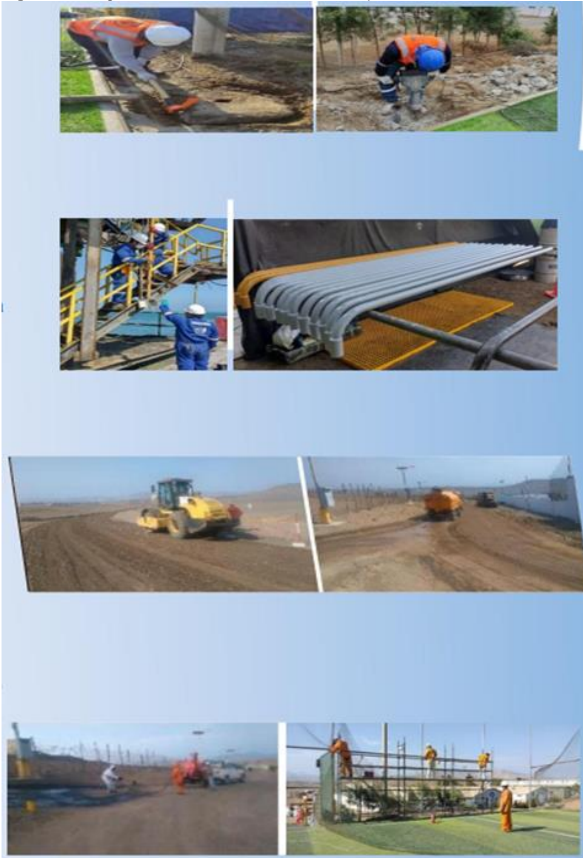
Figura 3. Fotografías de las instalaciones de la empresa.
