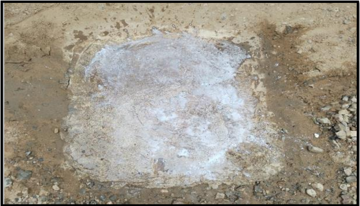
Foto 66. Paño de losa de concreto con adición de AM sometido a ataques químicos, simulando una losa destinada a lavado de vehículos.
