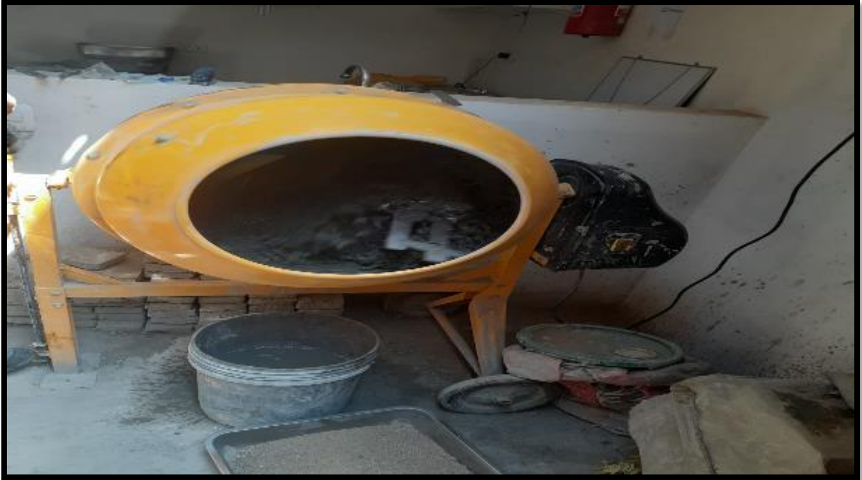
Foto 09. Trompo realizando la mezcla de concreto con la incorporación del almidón de maíz.
