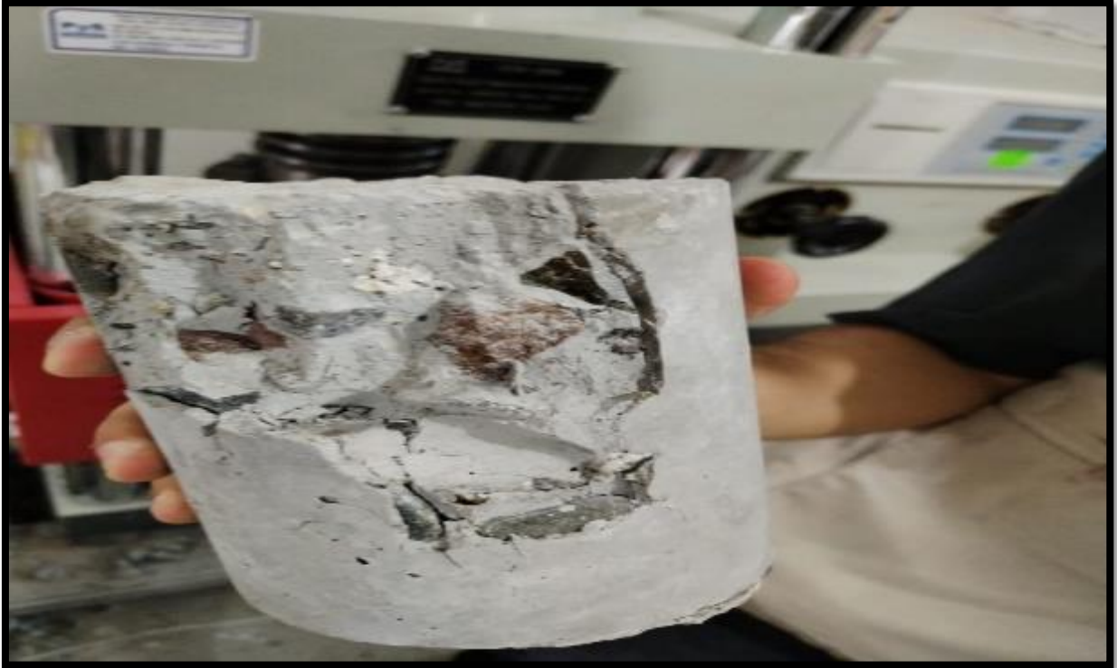
Foto 79. Falla de la probeta de concreto extraída de losa.
