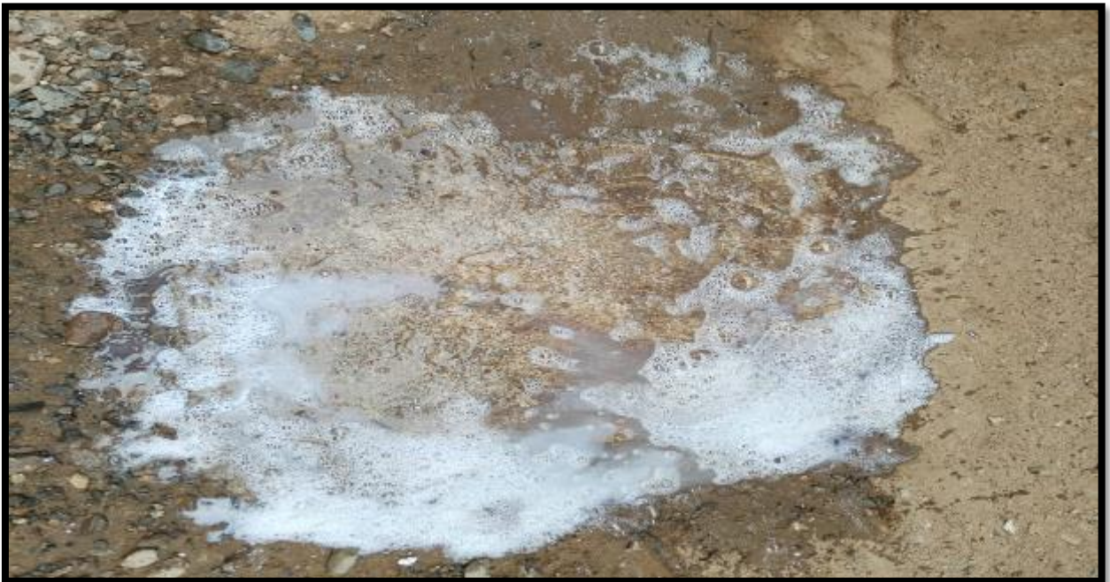
Foto 68. Paño de losa de concreto con adición de AM sometido a ataques químicos, en diferente día, simulando una losa destinada a lavado de vehículos.
