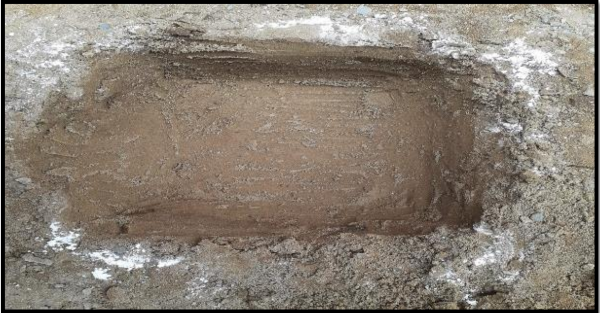
Foto 55. Excavación del paño de la losa donde se realizará el vaciado de concreto con AM al 5.00%.
