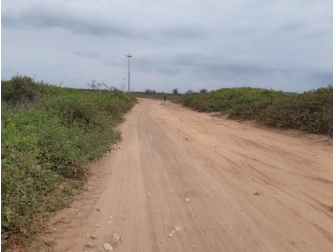
Figura 7. Ahuellamiento en el tramo.
